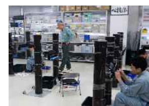
写真7. 光ケーブル接続（クロージャ）
