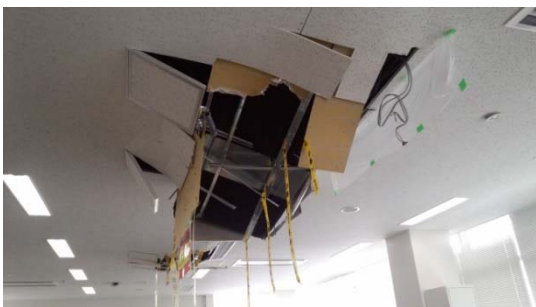
本社5階フロア(本震後)天井部分
