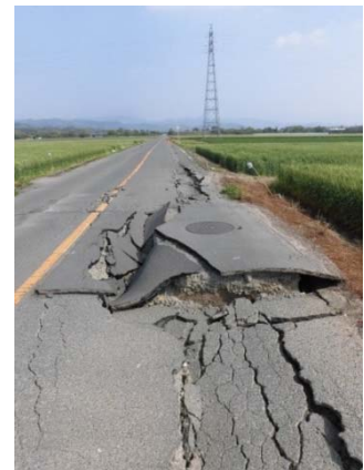
道路の隆起・陥没
