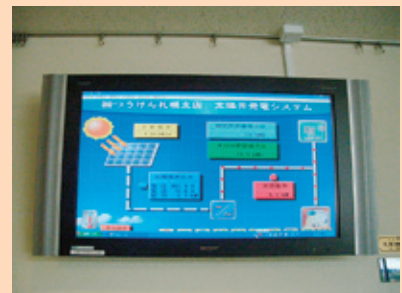
発電状況等の表示装置
