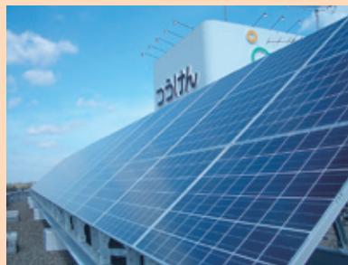
太陽光発電システム (10kw)
