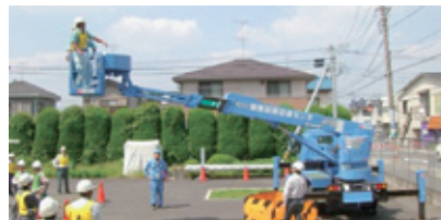
地盤養生不良における危険確認
