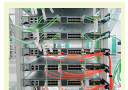
写真4 NTTビルに設置したNCCの通信機器
