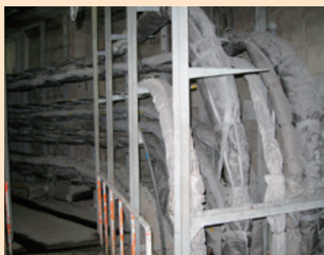
写真2 2階ステージから1階へのケーブル
