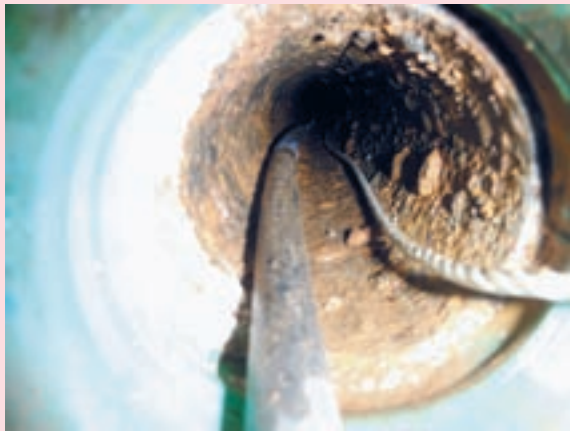
写真9 洗浄前 (No5~ No6 / No6ダクト部)
