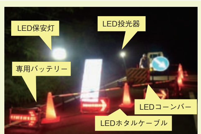
図11 工事中LED照明設備
