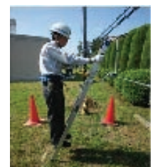
図5 引込線切断危険体感
