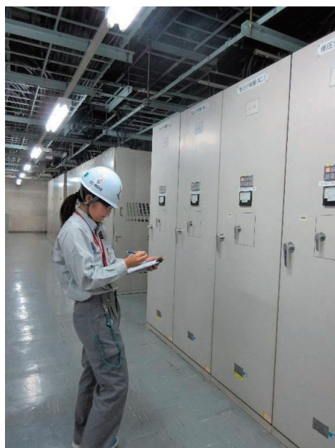
電力室にて手順書作成の現場調査
