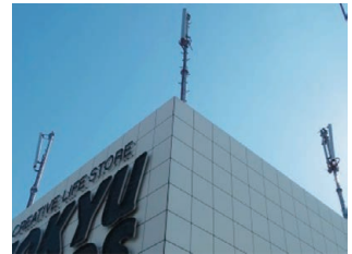
LTE無線基地局設備見学 (株式会社ミライト)
