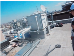
LTE無線基地局アンテナ設置工事見学 (日本コムシス 株式会社)
