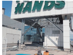
LTE無線基地局設備見学 (株式会社ミライト)
