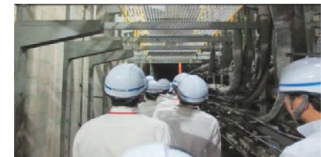
写真4 NTT東日本常盤ビルの通信設備見学
