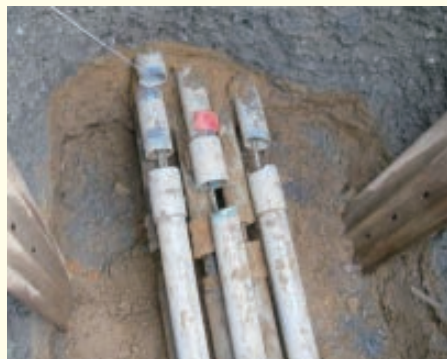
図1 地震による被災状況
