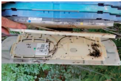
写真4 心線収納用品内、光ファイバ心線断線故障
