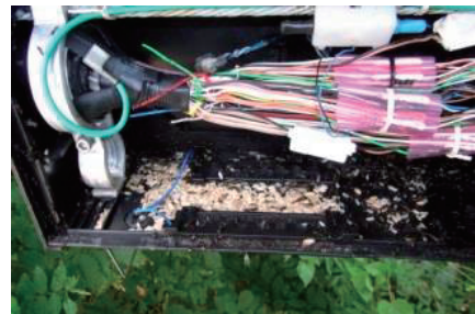
写真5 メタル接続端子かん内、心線絶縁不良
