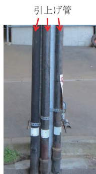
図2 電信柱の側部に設置された引上げ管
