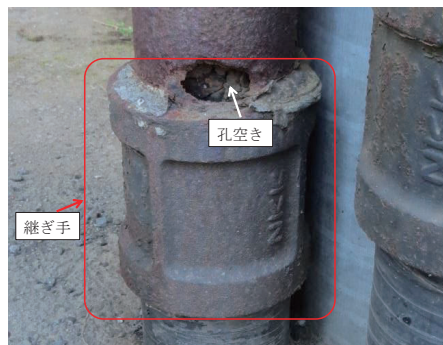
図3 腐食劣化によって継ぎ手の上部に孔空きが生じた引上げ管
