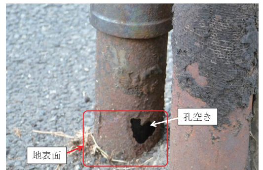
図4 腐食劣化によって地際周辺に孔空きが生じた引上げ管
