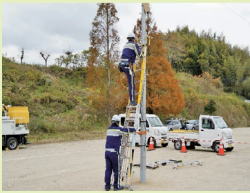
写真17 昇柱準備中の踏み外し事故実演
