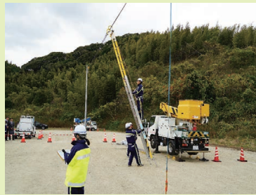
写真15 引込線張替え作業における梯子からの転落事故実演
