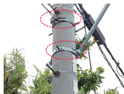
図5 屋外の通信設備の硫害対策の一例 (粉体塗装を実施した金属バンド)
