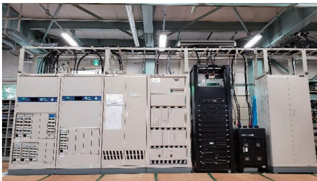
写真3 貸出利用可能設備例 電力実習棟1F（分散給電装置）
