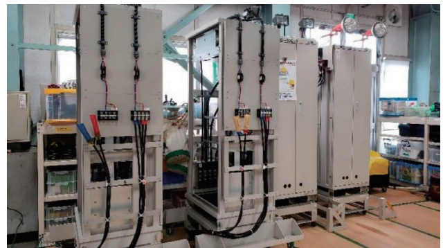
写真4 貸出利用可能設備例 電力実習棟1F（中間電流供給装置）
