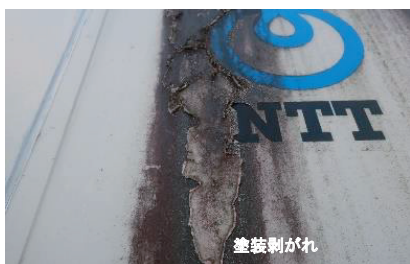
図3 壁面の付着物および塗装剥がれ箇所の拡大図
