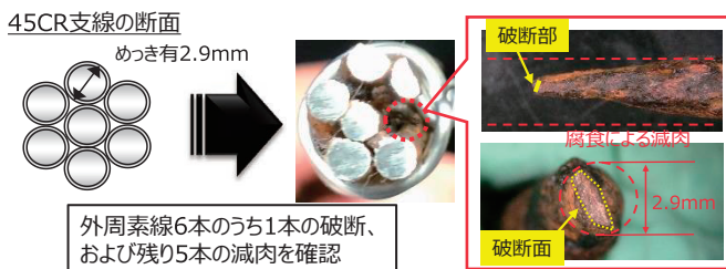
図3 当該腐食箇所の断面および外周素線腐食状況
