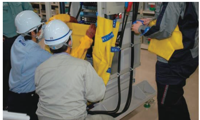
写真4 設備事故防止対策科（電力）
