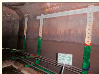
図1 MH内鋼材の腐食検出
