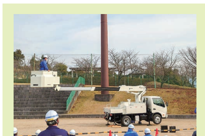
写真16 バケット車の傾き
