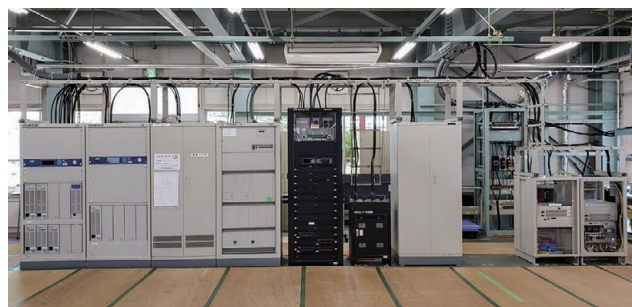
写真1 分散給電実習設備
