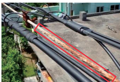
図1 つり線に発生した赤錆
